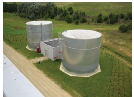
Αντλιοστάσιο - Δεξαμενές Πυρόσβεσης
