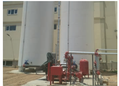
Μεταλλικές δεξαμενές Πυρόσβεσης
