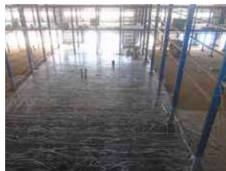
Εικ. 9B: Διάσπρωση φράγματος υδρατμών
