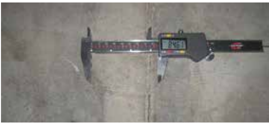
Εικ. 4 : Κατεστραμμένος κατασκευαστικός αρμός άνευ αρμοκαλύπτρου
