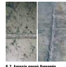
6-7. Αστοχία αρμού διακοπής σκυροδέτησης (2).
