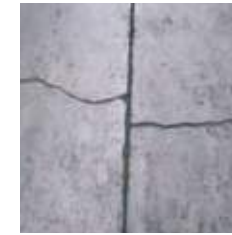
2. Ρηγμάτωση σε επαφή με αρμοκοπές.
