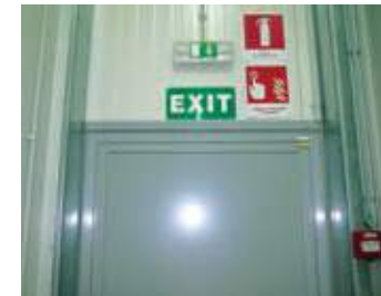
ΦΩΤ. 09. Σήμανση εξόδου διαφυγής.
