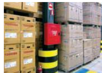
ΦΩΤ. 11. Σήμανση πυροσβεστικού σταθμού.
