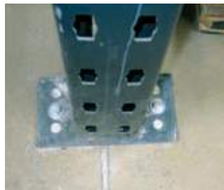
ΦΩΤ. 03. Ορθοστάτης ραφιών σε αρμοκοπή δαπέδου.
