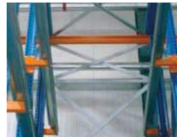
ΦΩΤ. 04. Προστασία δικτύου καταιονισμού.
