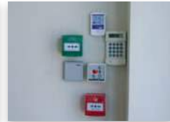
ΦΩΤ. 16. Συστήματα ελέγχου και προστασίας.
