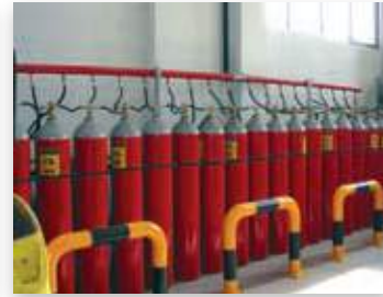
ΦΩΤ. 12. Φιάλες Inergen.
