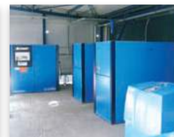
ΦΩΤ. 5. Εγκατάσταση Αεριοστασίου.
