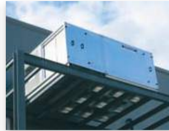
ΦΩΤ. 8. Εξωτερική μονάδα αερισμού.
