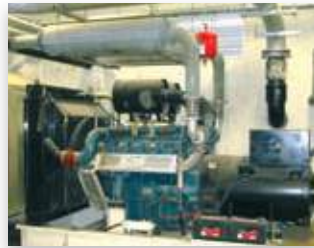
ΦΩΤ. 14. Εφεδρική λειτουργία ηλεκτροπράγματος ζεύγους.
