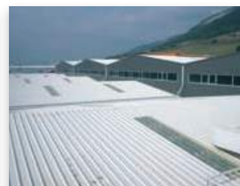
ΦΩΤ. 3. Εγκαταστάσεις διαχείρισης ομβρίων υδάτων.
