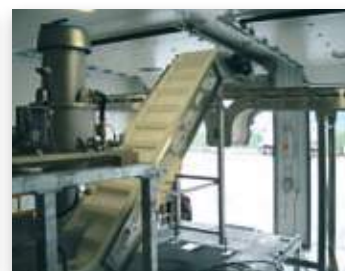
ΦΩΤ. 4. Αυτόματο σύστημα αποκομής στερεών αποβλήτων.
