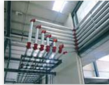
ΦΩΤ. 11. Δίκτυο καταιονισμού-εγκαταστάσεις ενεργητικής πυροπροστασίας.
