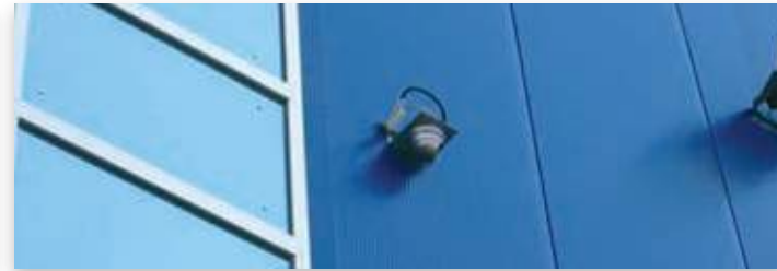
ΦΩΤ. 15. Περιμετρικές κάμερες σε μια τεχνική εγκατάσταση.
